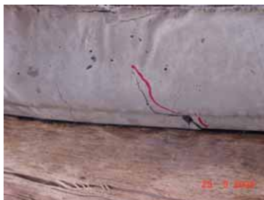
Figura 18 – Ruptura da laje de concreto com carregamento distribuído
